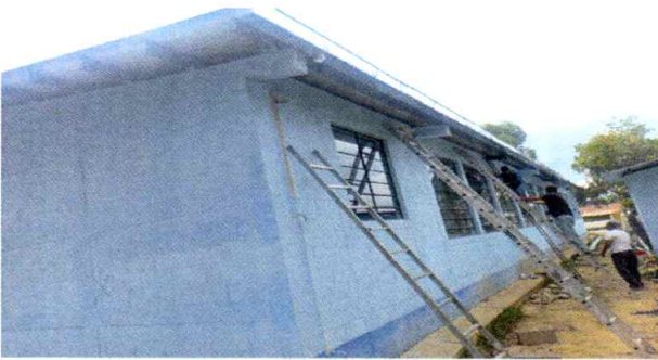
Foto 3: Instalación de canales de PVC en mal estado
